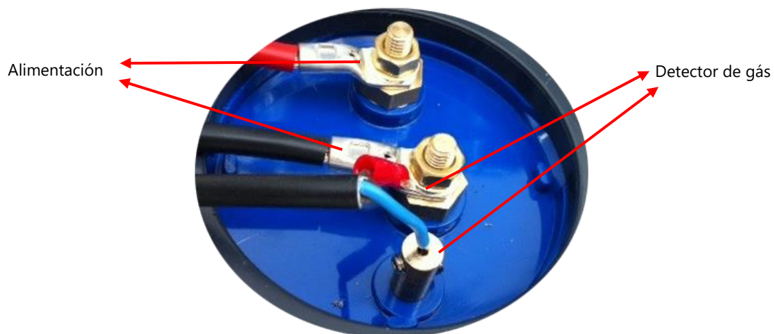
Figura 5 – Terminales de Conexión en la Celda
